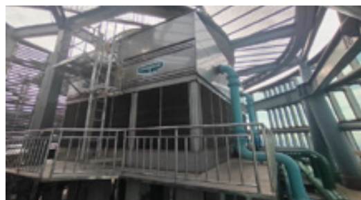
越秀房托对广州四季酒店冷却塔进行改造，改造后空调用电量对比 2019 年减少 21.5%，空调用水量对比 2019 年减少 23%
